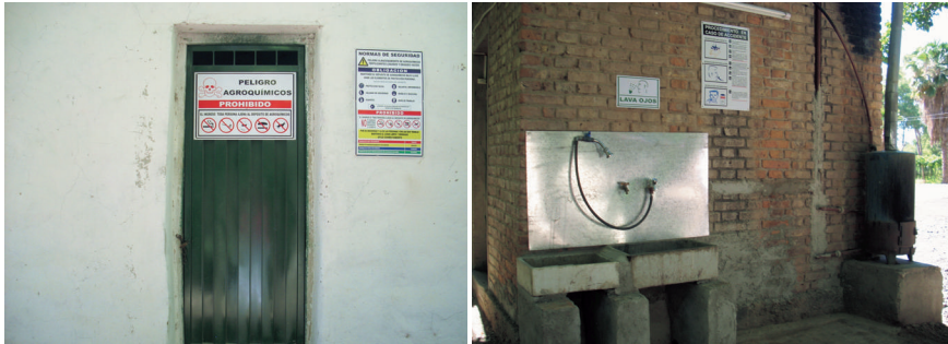
Figura 6. Ingreso a depósito de productos fitosanitarios convenientemente señalizado (izquierda). Lavaojos y ducha de emergencia (derecha).
