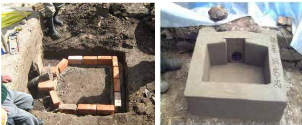
Figura 4.50. Poza de entrada al digestor
