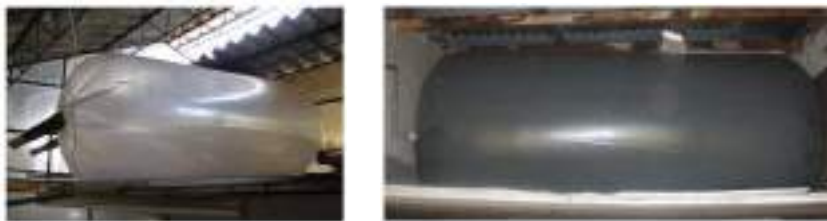
Figura 4.47. Reservorios de biogás de polietileno (izquierda) y PVC (derecha)
