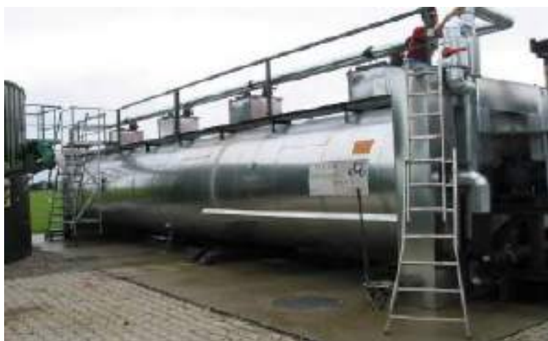
Figura 2.17. Digestor en carga en batch
